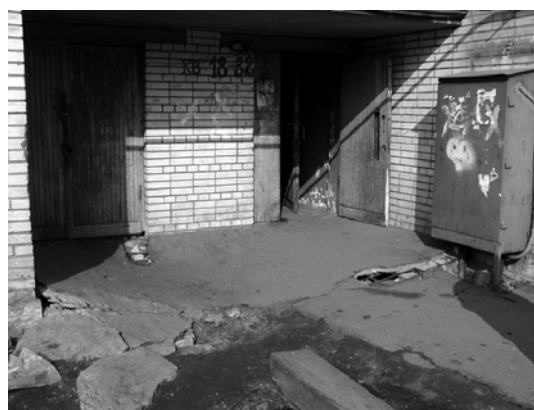
Рис. 5. Разрушение отмостки и асфальтового покрытия
