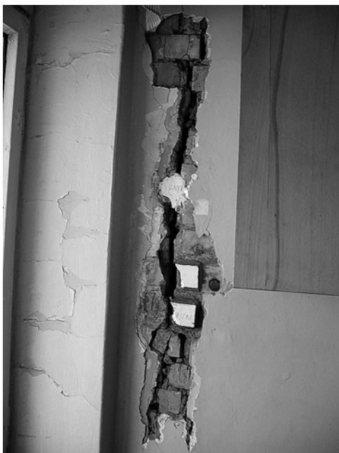
Рис. 7. Трещина во внутренней несущей стене по оси И
