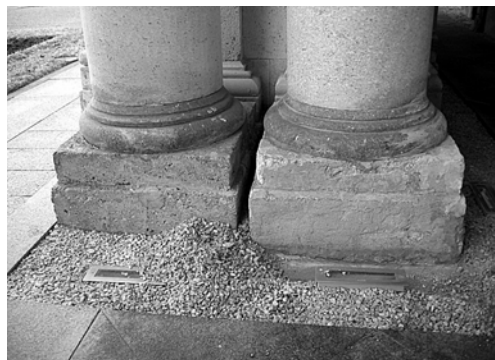
Рис. 2. Переувлажнение нижней части конструкций колонн
