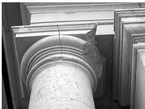
Рис. 1. Дефекты колонн лоджии №6
