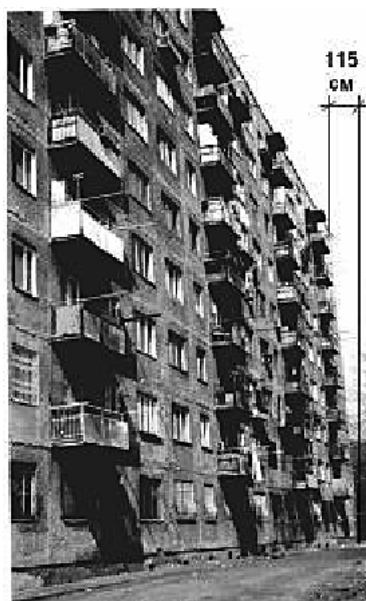
Рис. 7. Крен 9-этажного дома по ул. Готуа, 20 в Тбилиси
