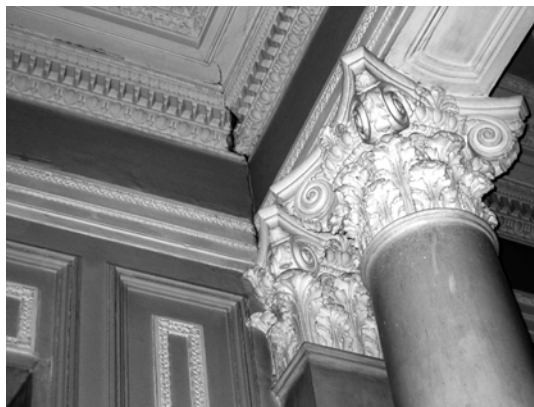
Рис. 12. Трещина, зафиксированная при обследовании декора особняка графа Шувалова
