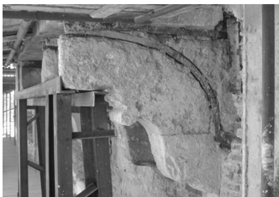
Рис.2. Балкон №4 (северный фасад восточного крыла). Две консоли из известнякового камня утрачены, воссозданы в виде оштукатуренной лепнины. Консоли являются несущими элементами конструкции. Стальные кронштейны являются конструктивными элементами, не рассчитаны на нагрузку от плиты балкона
