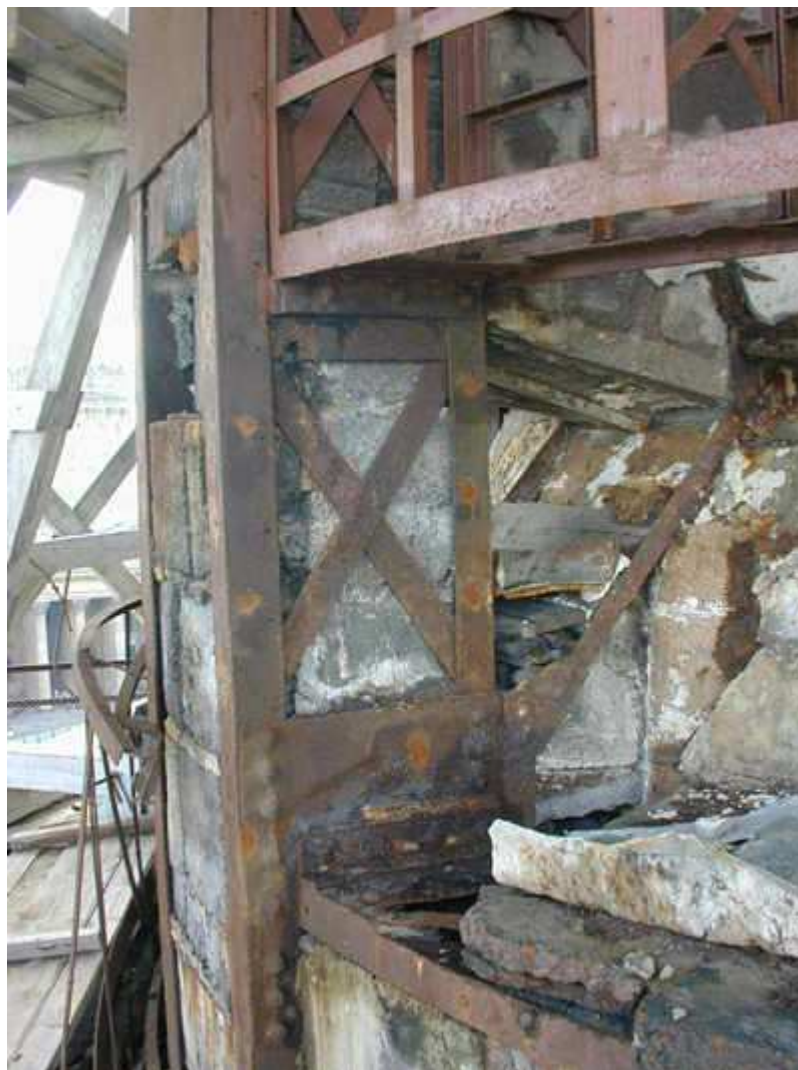
Рис.5. Пилон купола. Поясной лист толщиной 7мм полностью корродирован и удален при ремонте. Накладки, фасонки и элементы крепления горизонтального кольца жесткости корродированы – до 50% площади поперечного сечения.
